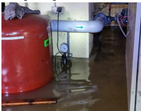
Fot. Zalane pomieszczenia kotłowni SP13
